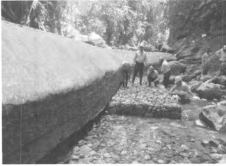
Trabajos de construcción de colchones Tipo Reno, en zona de captación de Shilcayo, Ing° Residente verificando trabajos
